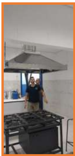
Manutenção da coifa
